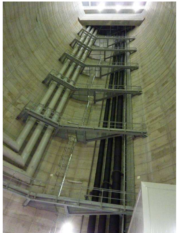
Inštalacije v jašku (vzbujanje, hladilna voda in drenaža).
